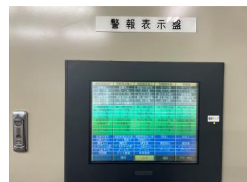
非常ボタンを押すと、職員室内の警報表示板で、校内のどこで異変が起きているかを確認することができる。
