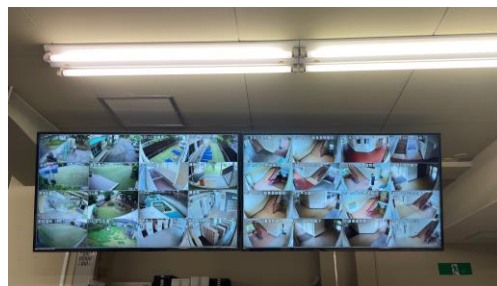
職員室内のモニターで防犯カメラの映像を常時確認することができる。
